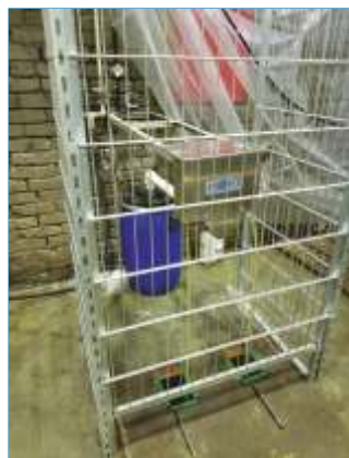
Скиммер TUV на очистных сооружениях моечного поста депо
